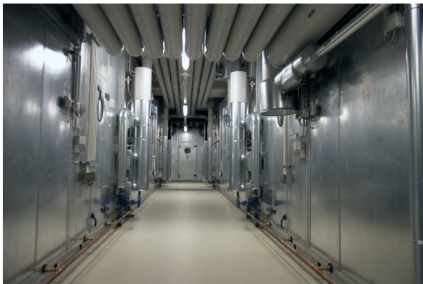
Abbildung: Prüfpflichtige RLT-Anlage
