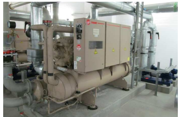
Abbildung: Prüfpflichtige Kälteanlage
